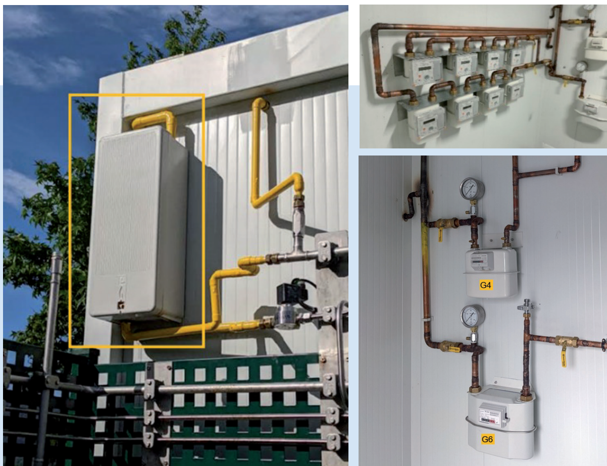
Figura 11 - Armario de regulación de vivienda (izq.) y contadores (dcha.)
