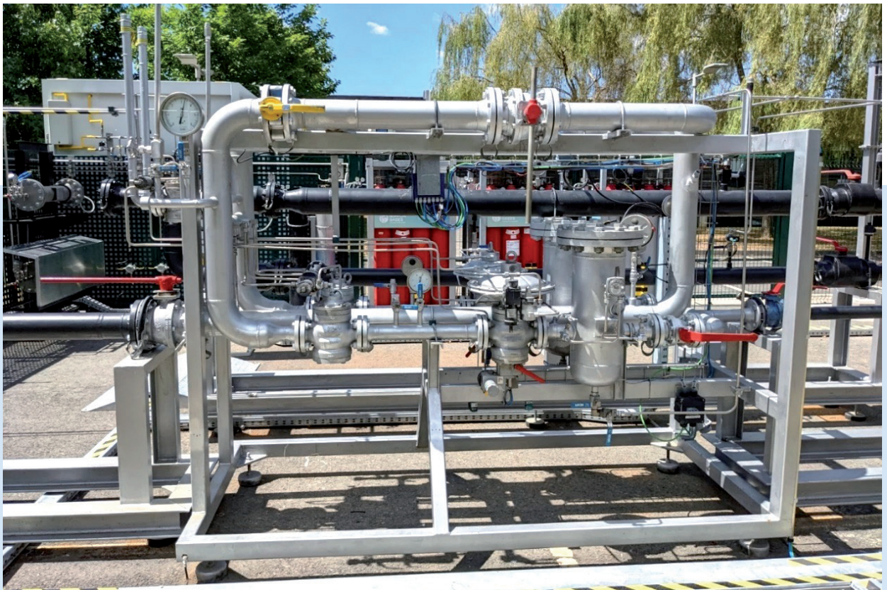
Figura 10 - Estación de Regulación y Medida (ERM)
