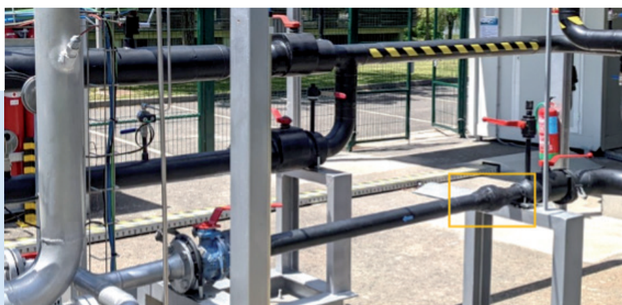
Figura 6 - Junta dieléctrica a la entrada de la ERM (línea 16 bar)
