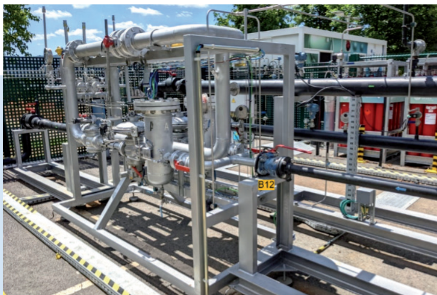
Figura 5 - Válvula de bola de acero a la entrada de la ERM (referencia B12)
