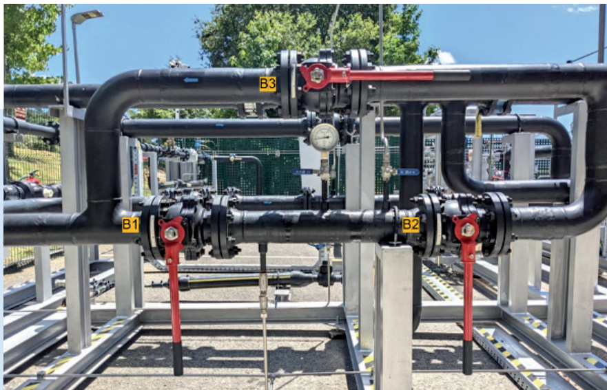
Figura 4 - Válvulas de bola de acero en la línea de alta presión (referencias B1, B2 y B3)
